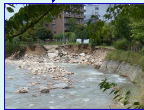
山口町上山口 (有馬川) (護岸の崩壊)
